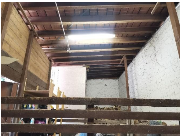
Abb. 6: Blick auf die Holzdecke (Innen), Zwischen Balken und Holzdecke sind kleinste Spalten zu sehen
