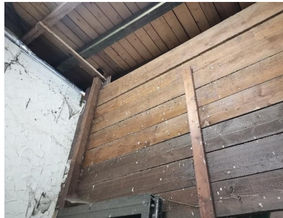
Abb. 5: Vogelkots Spuren an einer aus Holz bestehenden Trennwand in der Lagerhalle
